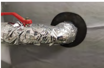
Dämmung Leitungen und Pufferspeicher | © B. Sandler, eNu
