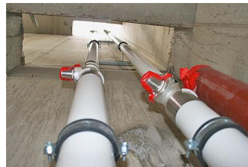
Steigleitung Quelle: IKZ.de
