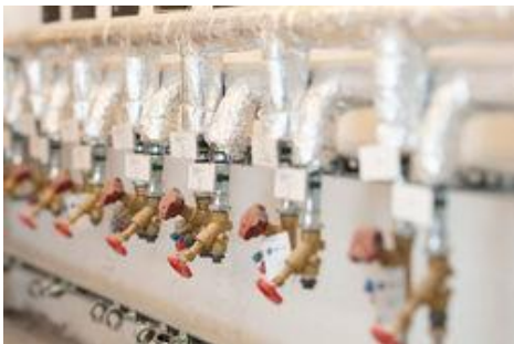
Verteiler am Dachboden Quelle: SOZIALBAU
