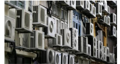
Warnung: Splitgeräte an Fassade Quelle: https://qz.com
