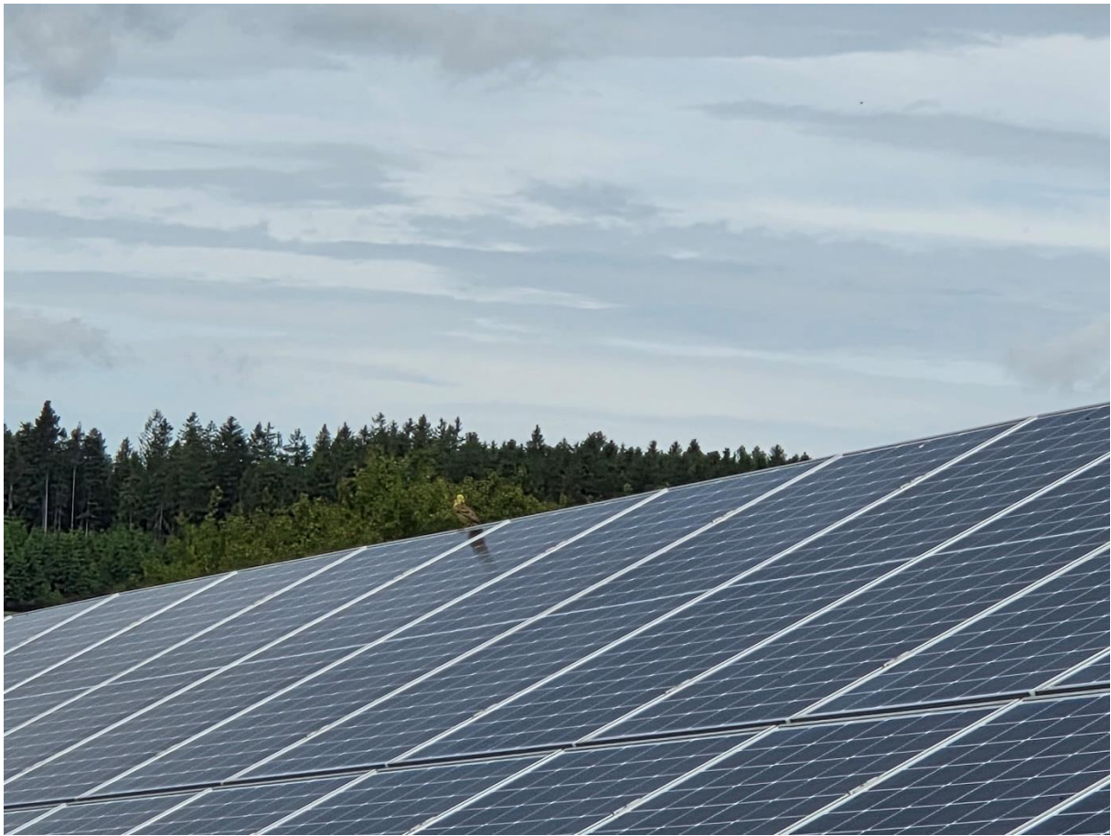
Abbildung 12: „Sonneninsel Kl. Pertholz“: Goldammer singt auf der PV-Anlage, der Neststandort befindet sich geschützt unter den PV-Modulen.
